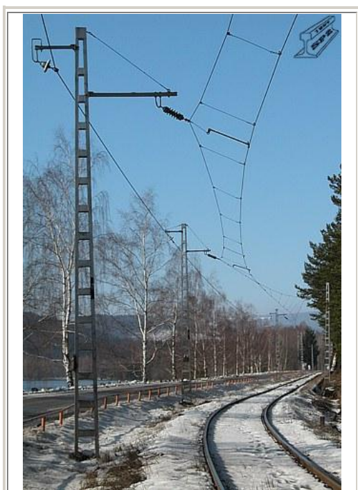
Šikmé polokompensované řetězkové vedení (foto Milan Šrámek 21. 2. 2003).
